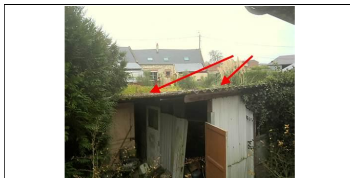
Photo n° DSCNA002 Localisation : Batiment Ouvrage : 1 - Couvertures, Toitures, Terrasses et étanchéités - Plaques ondulées et planes Partie d'ouvrage : Plaques en fibres-ciment (y compris plaques « sous tuiles ») Description : Plaques en fibres-ciment (y compris plaques « sous tuiles »)
