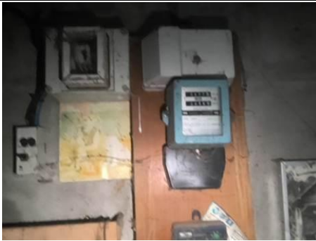
Photo du Compteur électrique
