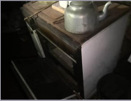
Photo DSCNDPE001 Ouvrage : Chauffage Description : detail_gen1#annee_installation
