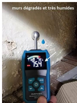
Pathologie : Présence d'humidité sur différentes parois opaques
