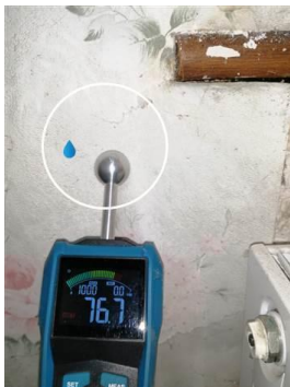
Pathologie : Présence d'humidité sur différentes parois opaques
