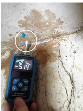
Pathologie : Présence d'humidité sur différentes parois opaques
