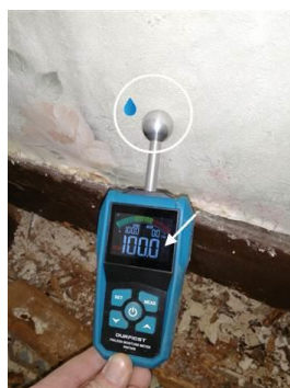
Pathologie : Présence d'humidité sur différentes parois opaques
