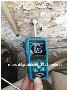
Pathologie : Présence d'humidité sur différentes parois opaques
