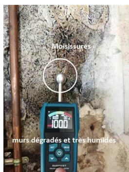
Pathologie : Présence d'humidité sur différentes parois opaques
