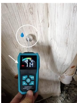
Pathologie : Présence d'humidité sur différentes parois opaques
