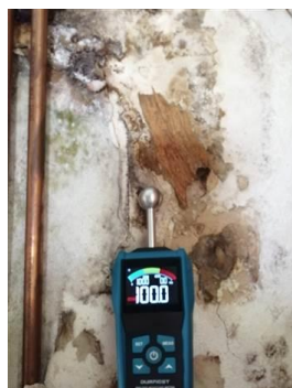
Pathologie : Présence d'humidité sur différentes parois opaques
