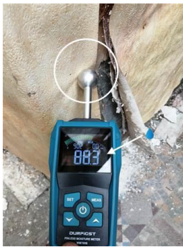
Pathologie : Présence d'humidité sur différentes parois opaques
