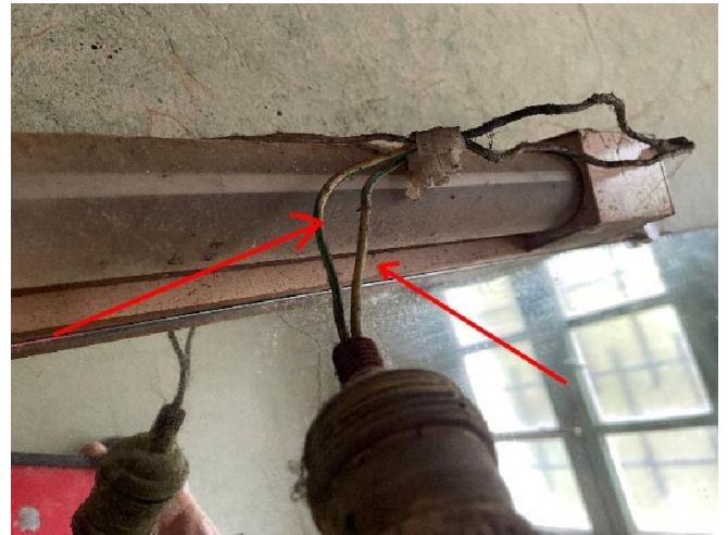
B.8.3 c) : L'installation comporte au moins un conducteur actif repéré par la double coloration vert et jaune. Observation : Conducteurs vert/jaune.
