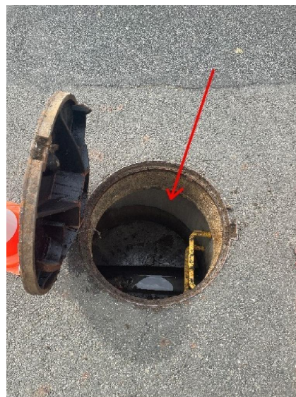
Tampon collecteur sur la chaussée.
