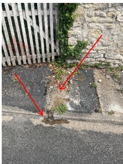
Ecoulement de l'eau de l'évier cuisine sur le trottoir.
