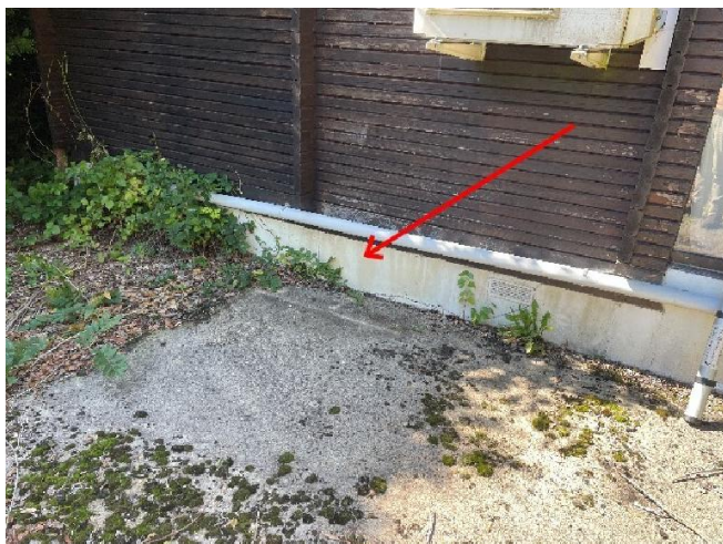
Exterieur : sous bassement Est Plaques fibres ciment AMIANTE
