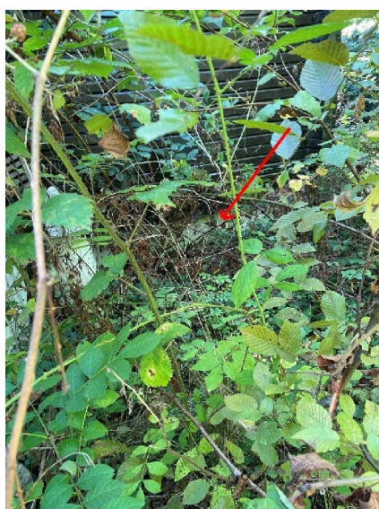
Exterieur : Sous bassement Nord Plaques fibre-ciment AMIANTE
