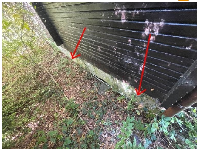
Exterieur : Sous bassement Sud Plaques fibre-ciment AMIANTE
