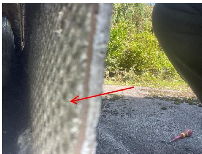
Exterieur : Détail plaque fibre-ciment AMIANTE
