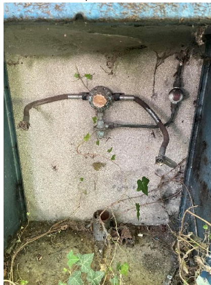
Zd2 : La lyre GPL est dangereuse. Observation : DGI Retrais des bouteilles pour condanation de l'installation.
