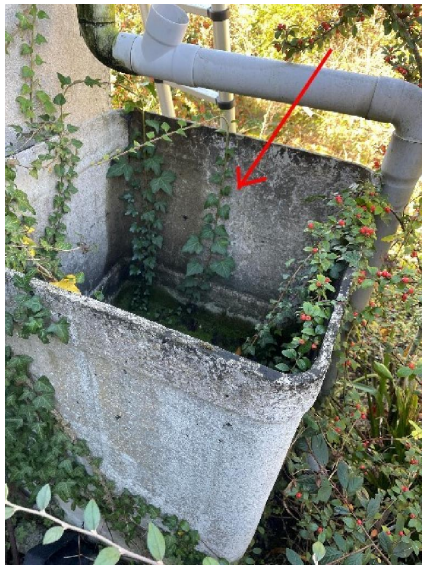
Extérieurs : Atelier 01. Bac récupérateur d'eau en Fibre-Ciment.
