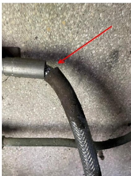
Zd2 : La lyre GPL est dangereuse. Observation : Lyre abimée.
