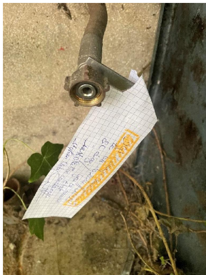
Zd2 : La lyre GPL est dangereuse. Observation : DGI Pose d'une étiquette rapenllant le DGI Lyre en mauvaise état. Condanation de l'installation par retraits des bouteilles.
