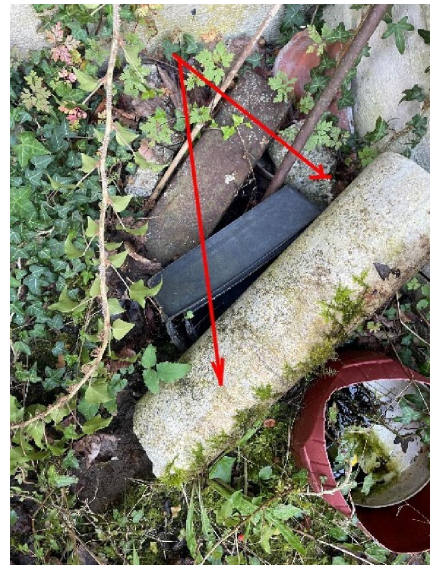
Extérieurs : Atelier 01 Conduits en Fibre-Ciment
