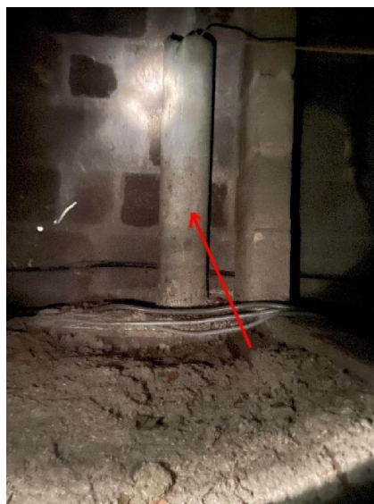
Combles 02 : Conduits fumée en Fibre-Ciment
