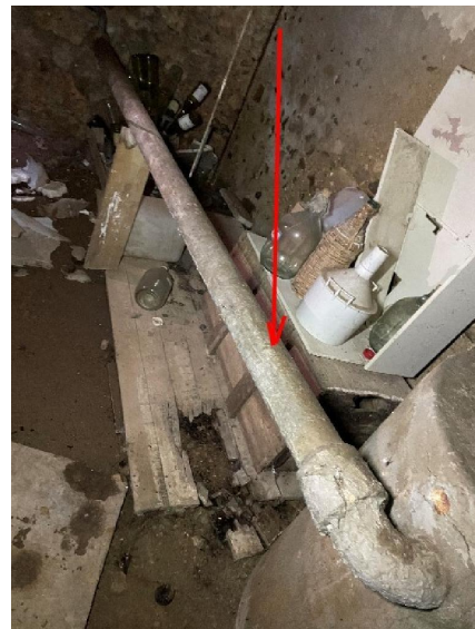
Maison 02 : Cave local 01 Conduit fibre-ciment (à l'horizontal au milieu de la cave)
