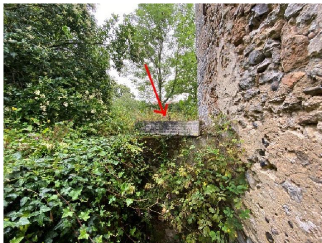
Exterieurs : Mur Sud/Ouest de la grange, proche descente de la cave. Jardinière en fibre-ciment.
