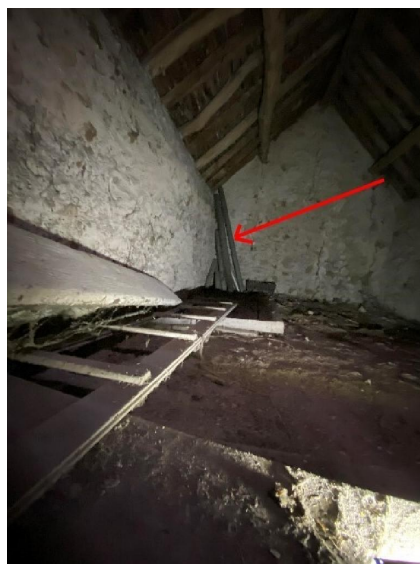
Maison 01 Comble local 01/02 Conduits non examinés. L'accès au comble est dangereux et non sécurisé.
