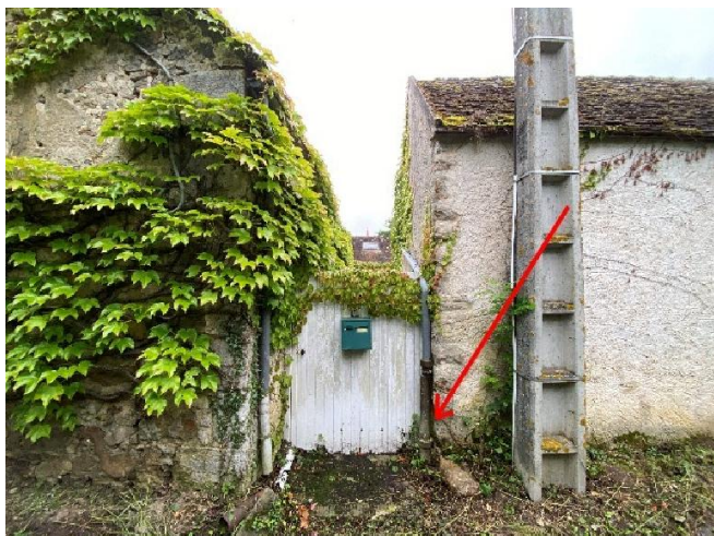
Exterieurs. Conduit fibre-ciment.
