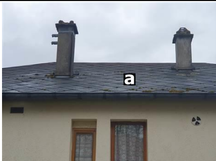
Photo n° Ph017 Localisation : Combles - Combles non habitables Ouvrage : Toitures Partie d'ouvrage : Ardoises (fibres-ciment) Description : Ardoises (fibres-ciment) Localisation sur croquis : M010
