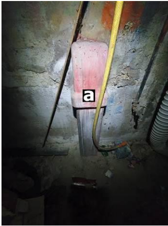
Photo n° Ph003 Localisation : Sous-Sol - Local Chaudière Ouvrage : Conduits de fluides (air, eau, autres fluides) Partie d'ouvrage : Conduits Description : Conduit de ventilation en fibro-ciment Localisation sur croquis : M003
