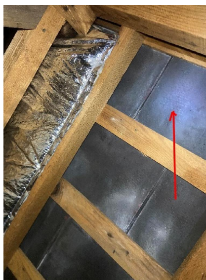
Toiture Maison. Détail ardoise amianté.
