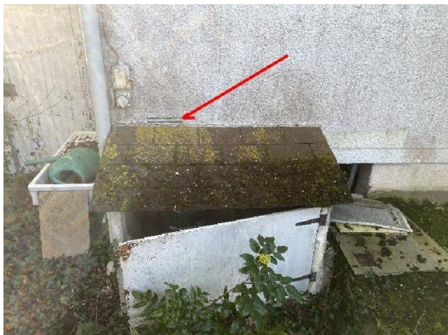
19.7 : Le dispositif de l'amenée d'air du local équipé ou prévu pour un appareil d'utilisation est obturé. Observation : Ammenée d'air obturée par la construction "niche" bouteilles de gaz.
