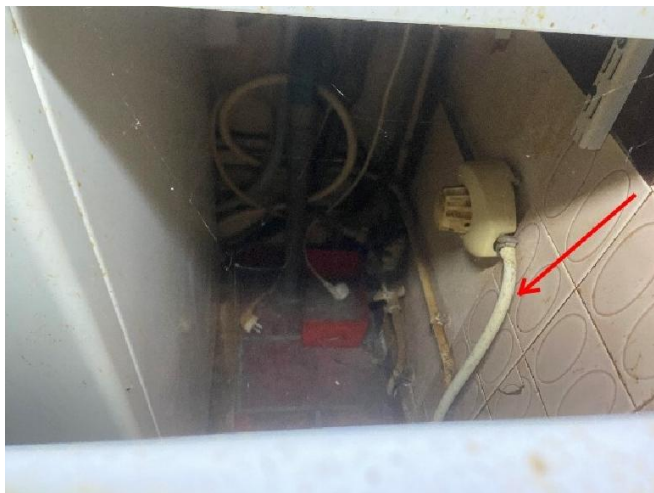
11a : Au moins un appareil est raccordé en gaz avec un tube souple. Observation : Alimentation cuisinière.
