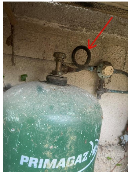
7d4 : La date limite d'utilisation de la lyre GPL en caoutchouc armé n'est pas lisible ou est dépassée. Observation : Plus de marquage lisible sur le lyre.
